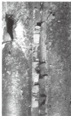
图1 水冷壁爆管现场
